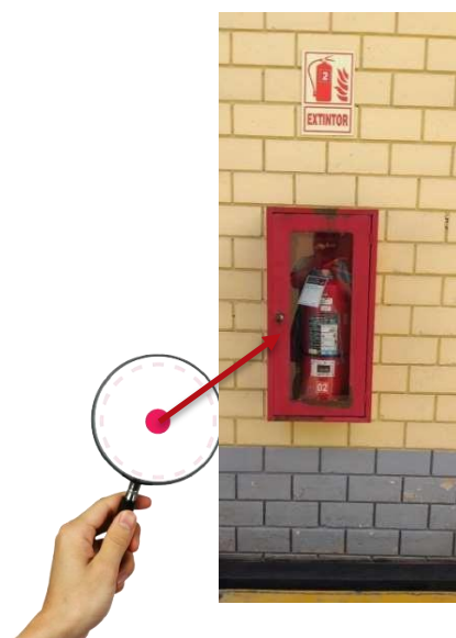
Imagen 5: Gabinete para extintor
