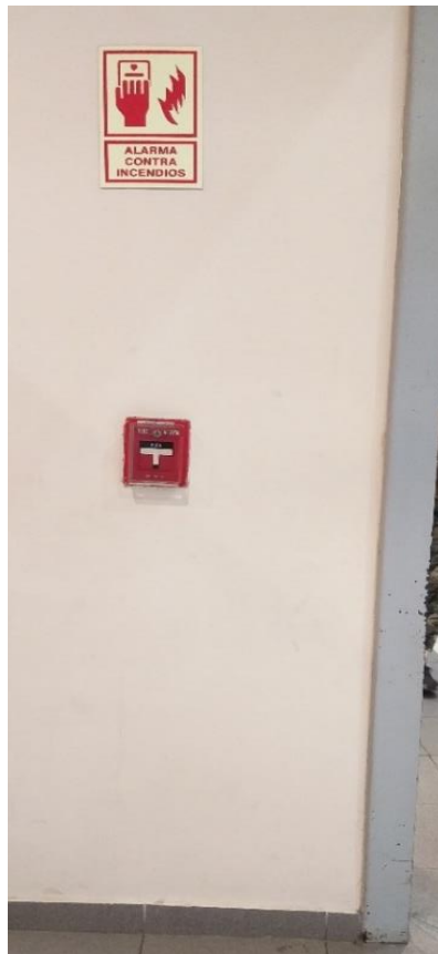
Figura 26: Cartel alarma contra incendios
