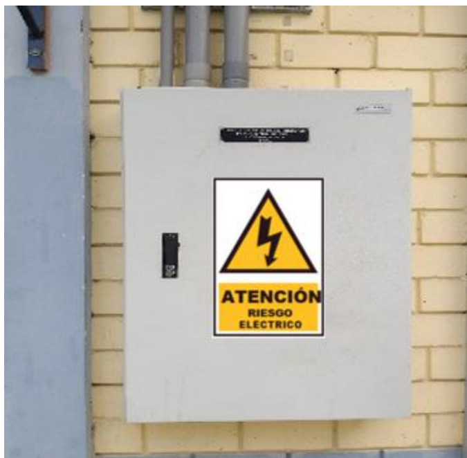
Imagen 22: Tablero eléctrico con cartel de riesgo eléctrico
