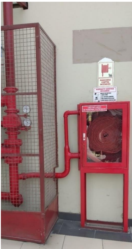
Figura 25: Cartel manguera contra incendios
