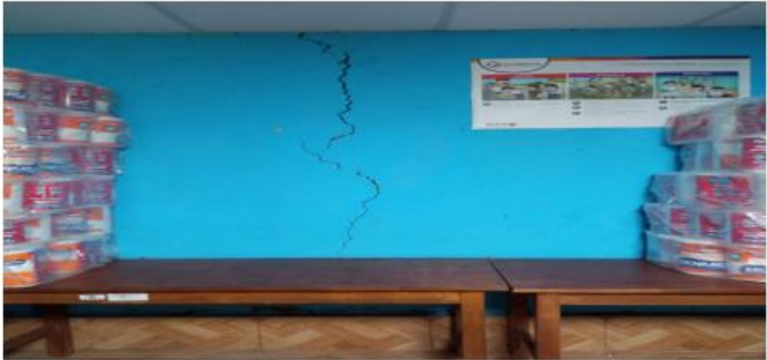
Fisuras en los muros del comedor de la IE. N°82983
