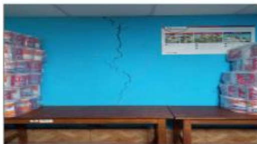
Fisuras en los muros del comedor de la IE. N°82983
