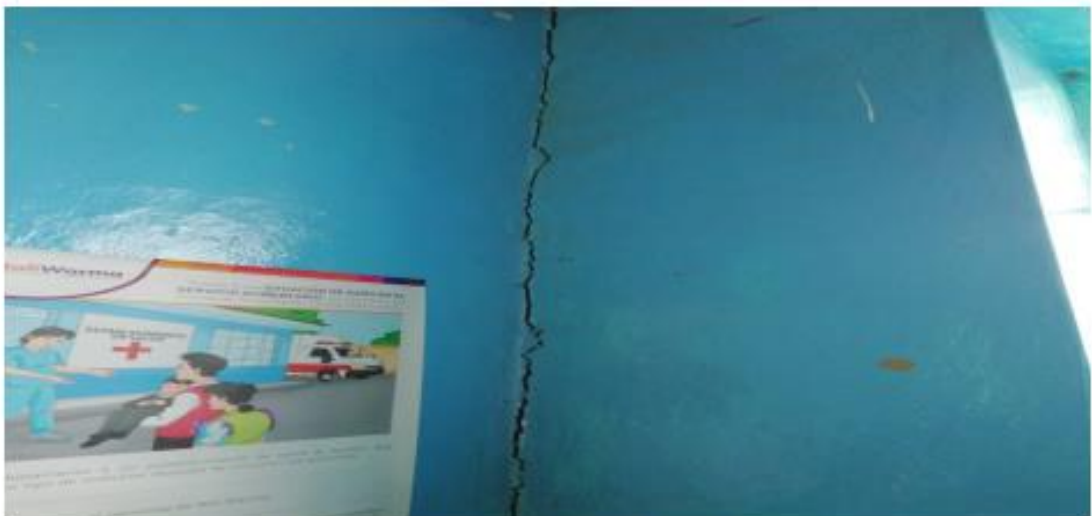
Fisuras en los muros del almacén de la IE. N°82983
